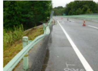
【事故発生時の現場状況】
